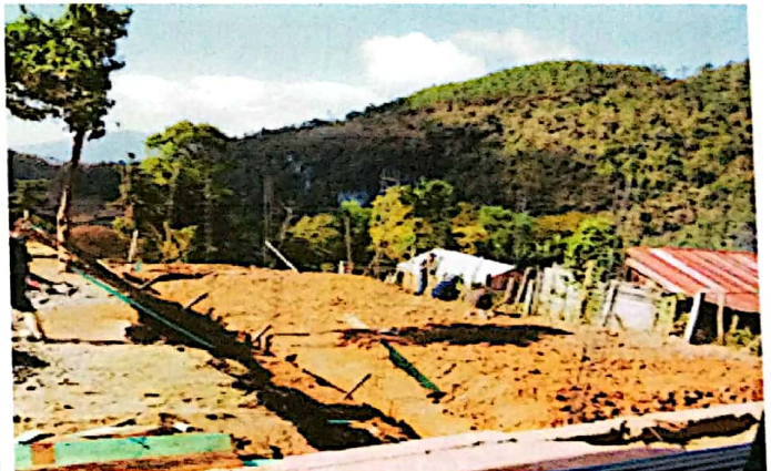
Foto 4: Mejoramiento de loza ya que los niños reciben clases en suelo de tierra
